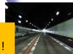
トンネル照明
